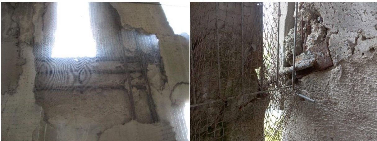
Рис. 2. Порушення зв'язку між закладними деталями
